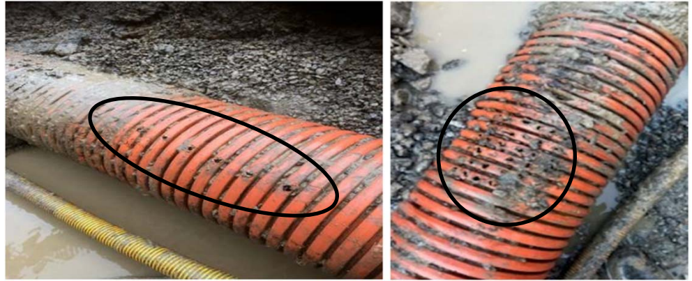
Figur 4. Perforerad lakvattenledning – sannolikt avsedd att dränera schakt i samband med anläggningsarbeten 2010.
